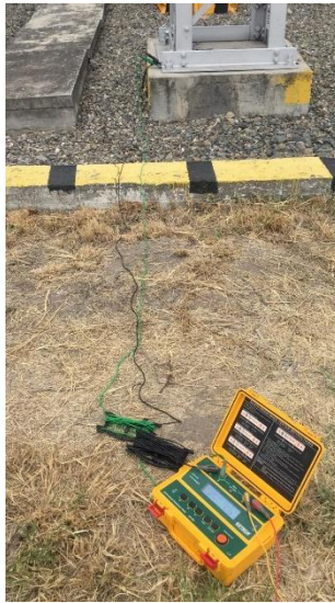
Fotografía 4. Valor medido de resistencia de PT en SE Catamayo, 0.28 \Omega
